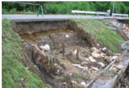
道路法面の崩壊状況
